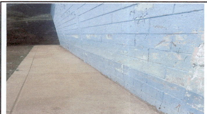
Foto 4: Pintura exterior de la pared de todas las aulas.
